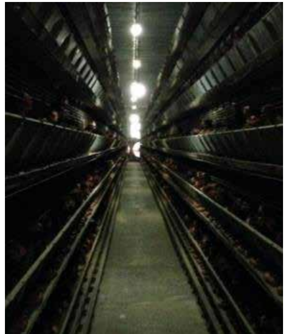
Figura 18. Las luces LED instaladas en este galpón están colocadas demasiado direccionales, muy separadas y no son suficientemente brillantes. La combinación de estos factores conducen obviamente a sombras en el piso y a una mala uniformidad de luz en las jaulas.
