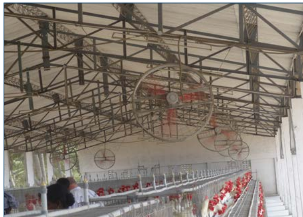
Figura 4. Ventilatori e nebulizzatori incrementano la velocità dell'aria e creano un effetto di raffrescamento.
