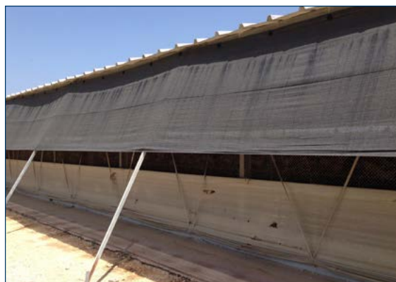
Figura 9. Teli porosi scuri impediscono alla luce solare diretta di entrare nel capannone e consentono il passaggio dell'aria.
