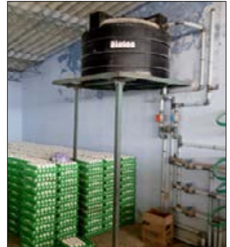
Figure 12. Bac d'eau à l'intérieur du bâtiment permet de garder une eau plus fraîche.
