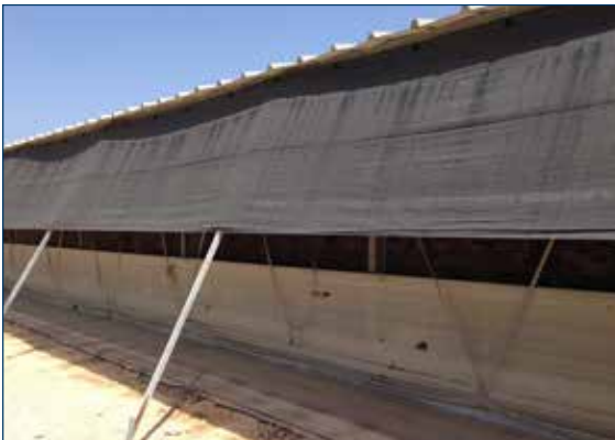
شكل 9. مظلات مسامية للنوافذ تحجب ضوء الشمس المباشر، لكن تسمح بمرور الهواء لداخل العنبر.
