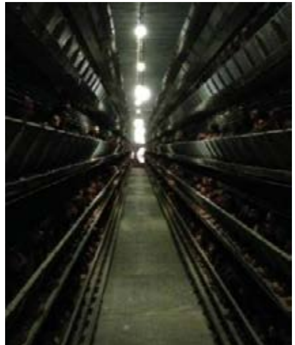
Figura 18. Las luces LED instaladas en este galpón están colocadas demasiado direccionales, muy separadas y no son suficientemente brillantes. La combinación de estos factores conducen obviamente a sombras en el piso y a una mala uniformidad de luz en las jaulas.
